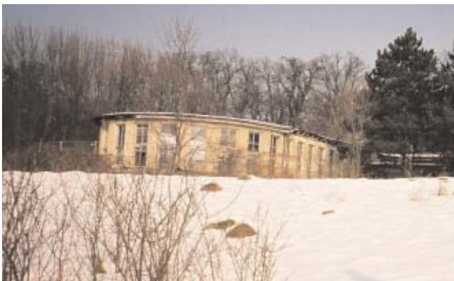
Höchste Zeit für Sanierung des Afritsch-Heims: Das Dach des Saaltraktes ist bereits eingebrochen.
